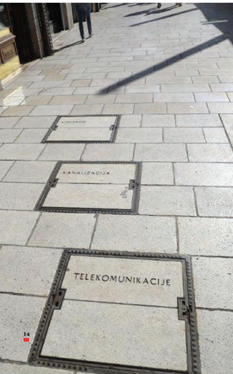
Обозначаване на собствеността на шахтата в настилната или върху рамката на капака
